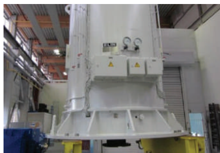
silnik HKR 1801304 1835 kW, 3,3 kV 52,25 Hz napęd do pompy, Elektrownia Kozienice
