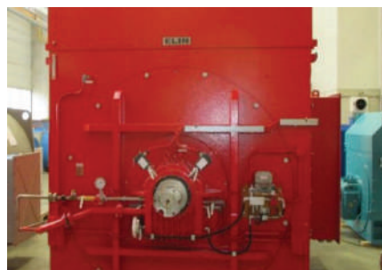
Silnik: HKM 111204 21700 kW, 10 kV 60,5 Hz napęd do pompy, Elektrownia Kozienice
